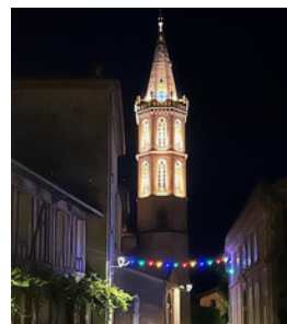
Nouvel éclairage LED du clocher
